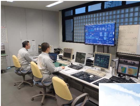
～中央浄水場内操作室～
