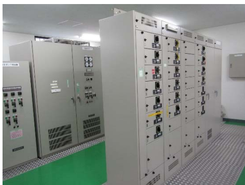
～中央浄水場 動力盤～
