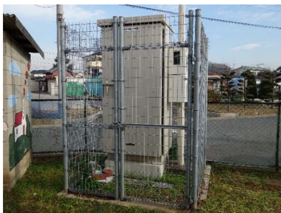
～古新田保育所 水質自動監視装置～
