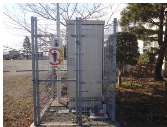
～コミュニティセンター 水質自動監視装置～
