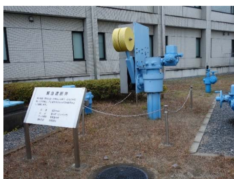
～中央浄水場 緊急遮断弁～
