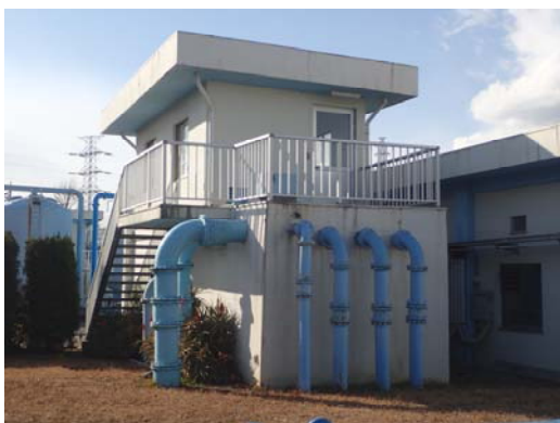
～中央浄水場 着水井～
