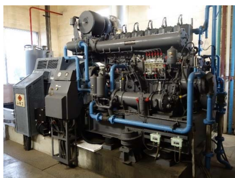
～中央浄水場 自家発電設備～
