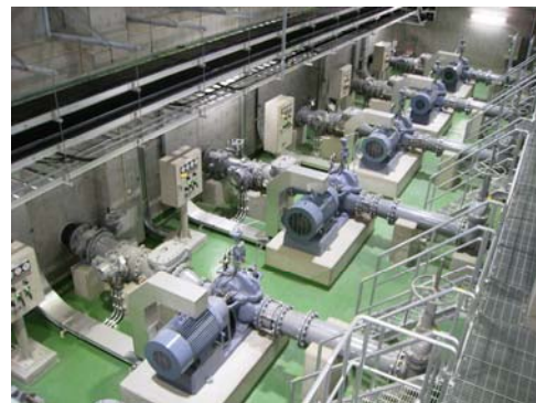
～中央浄水場 配水ポンプ～
