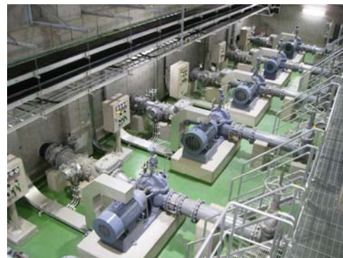
～中央浄水場 配水ポンプ～
