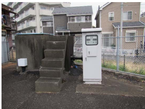
～第 5 号水源井（従前）～
