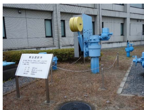
～中央浄水場 緊急遮断弁～
