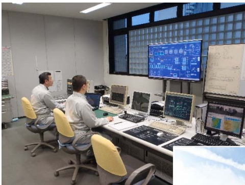
～中央浄水場内操作室～
