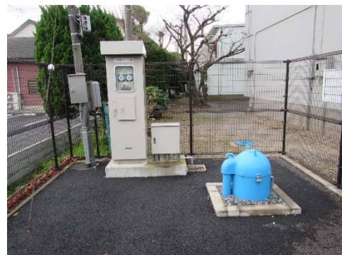
～第 7 号水源井（更新後）～
