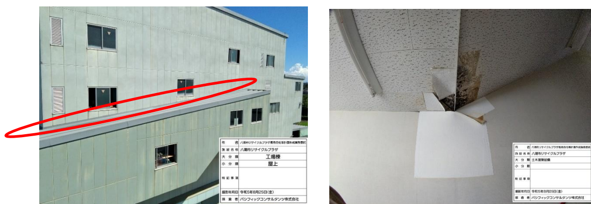
図 3-8 見学者廊下における隙間（赤丸内）及び雨漏れ状況
