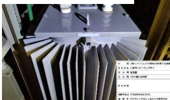
変圧器 (200V 用動力主幹盤内)
