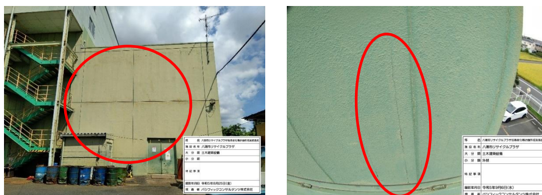
図 3-9 工場棟壁面のひび割れ（南面及び東面）
