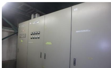
建築動力制御盤・プラント動力制御盤
