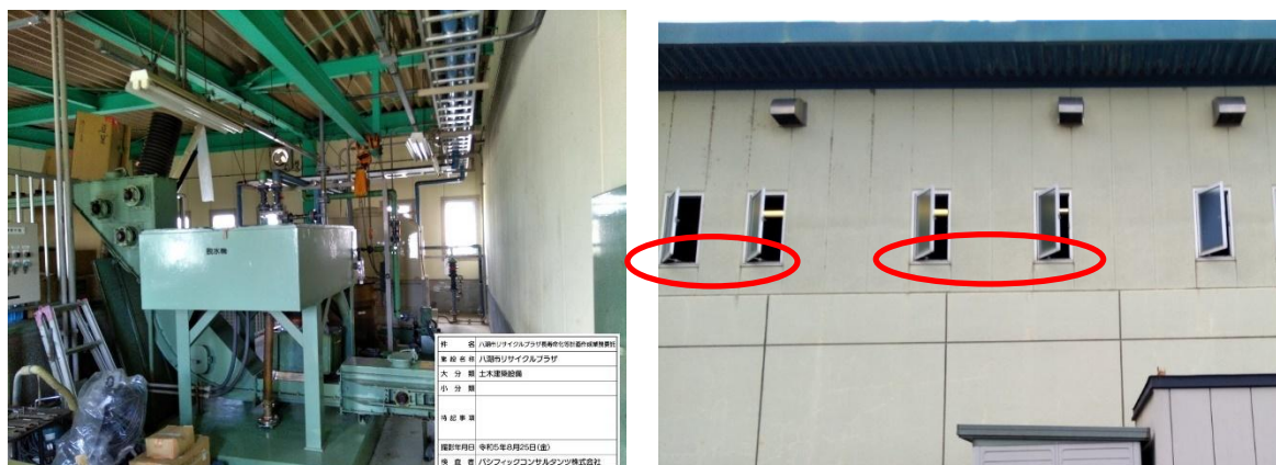
図 3-10 水処理施設内及び窓枠下部のひび割れ（赤丸内）
