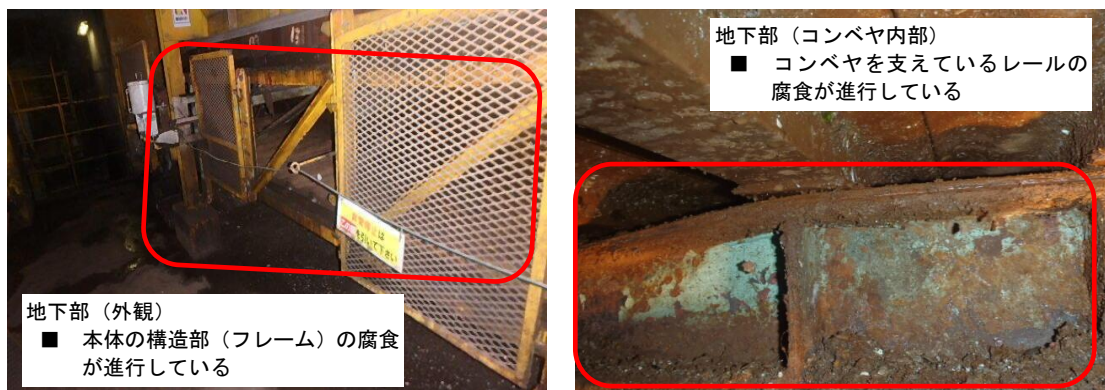
図 3-6 破砕物供給コンベヤの状況
