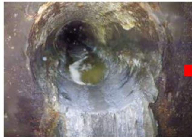
管渠上部腐食状況
