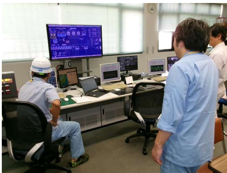
中央浄水場操作室
