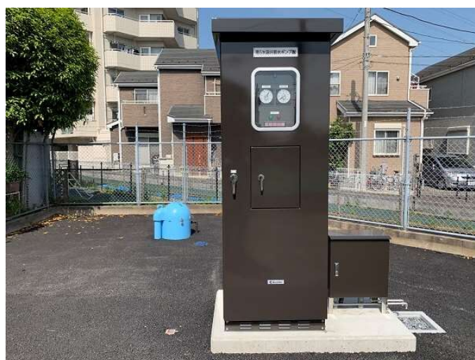
自己水源井（5号水源井）
