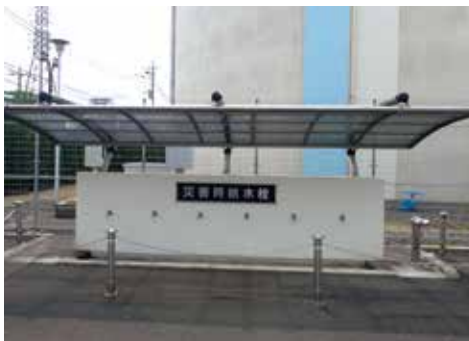
災害時給水栓
