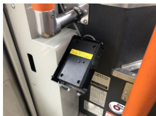
▲前扉付近の赤外線センサー
