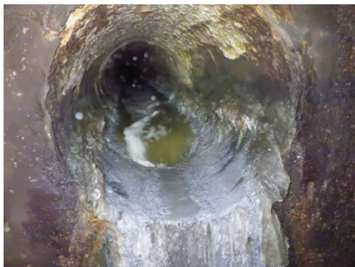
管渠上部腐食状況
