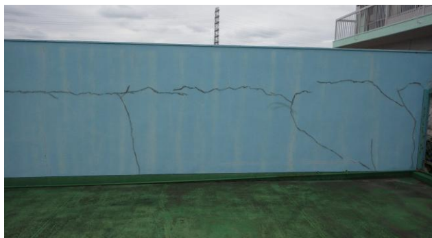
八條小学校 プール壁亀裂
