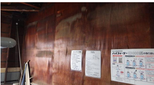
中川小学校 機械室壁 湿気による歪み
