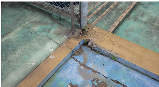
潮止小学校 プール床劣化
