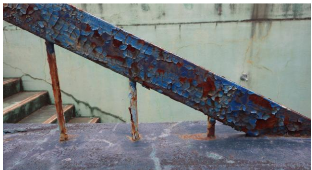
潮止小学校 シャワー手すり劣化
