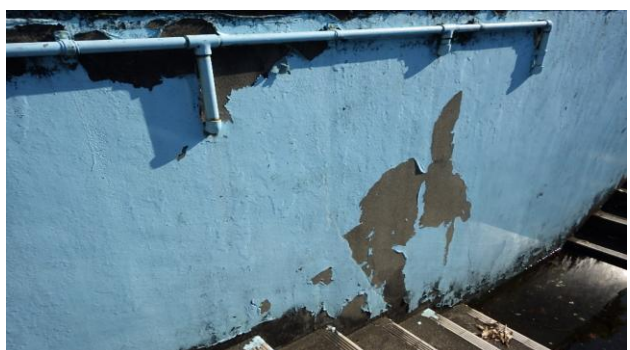
松之木小学校 シャワー壁劣化
