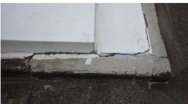
大瀬小学校 プールサイド劣化
