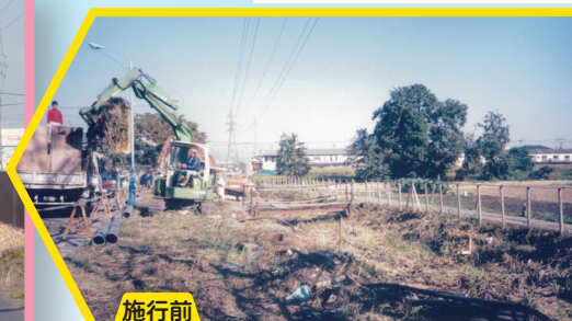
施行前 歩道、車道を分離させた道路となり、地域の安全性が向上するとともに、市域の南北交通の利便性も高まりました。
